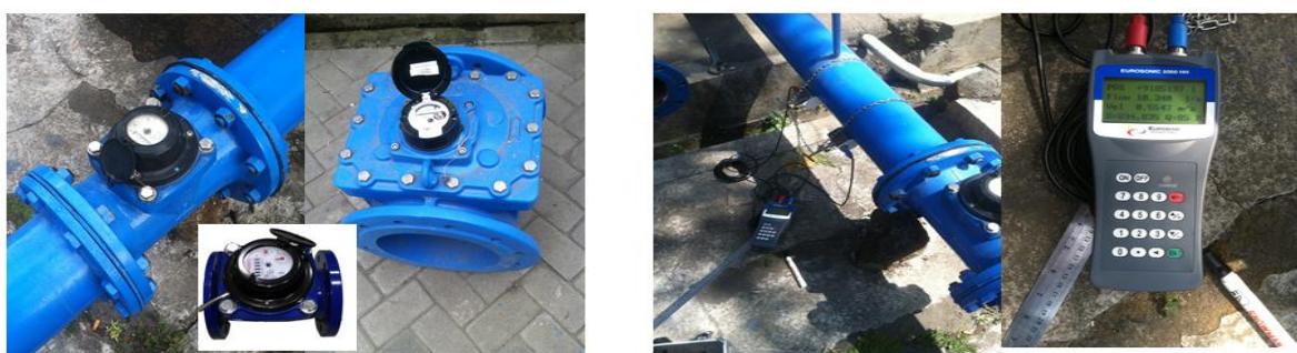
Gambar 7. Water Meter dan Ultrasonic Flowmeter
